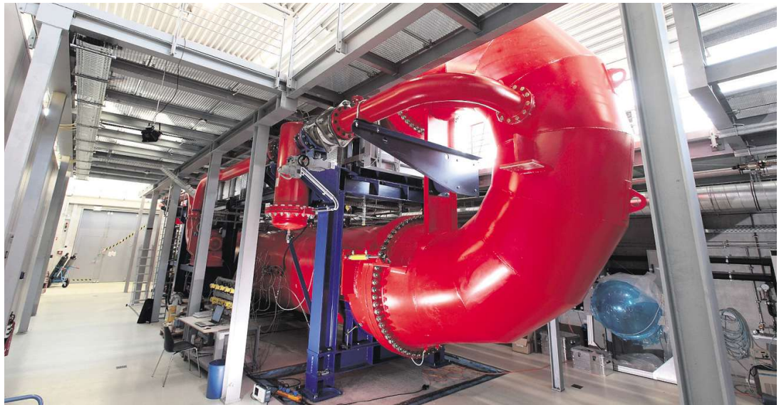
18 Meter lang, sechs Meter hoch und seit 2009 im Einsatz: der Göttinger Turbulenz-Windkanal.
